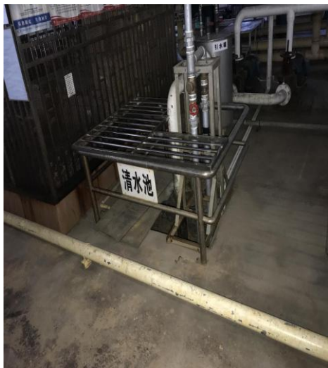
附图 1:室内地埋集水池
