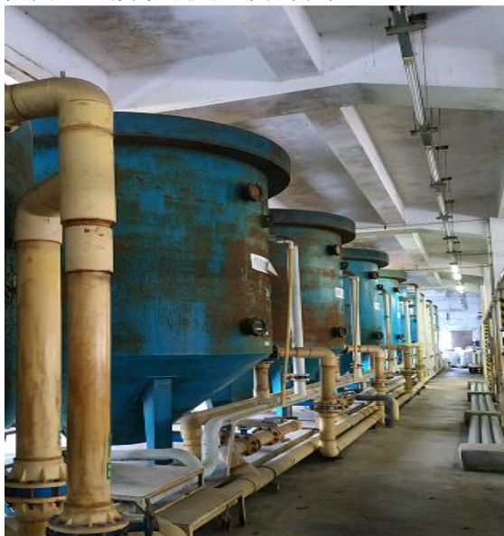
附图 2:旧废水站反应罐及内部
