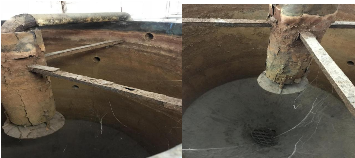
附图 2:旧废水站反应罐内部
