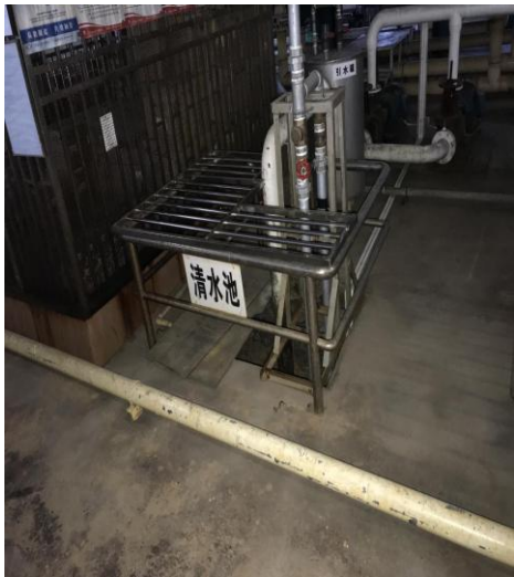
附图 1:室内地埋集水池
