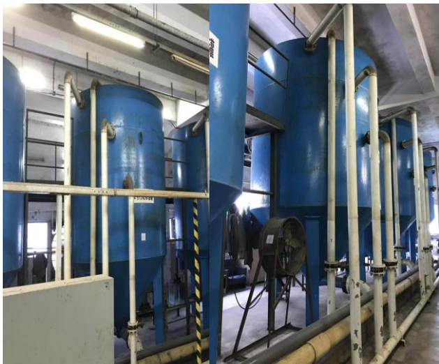
附图 2:旧废水站反应罐
